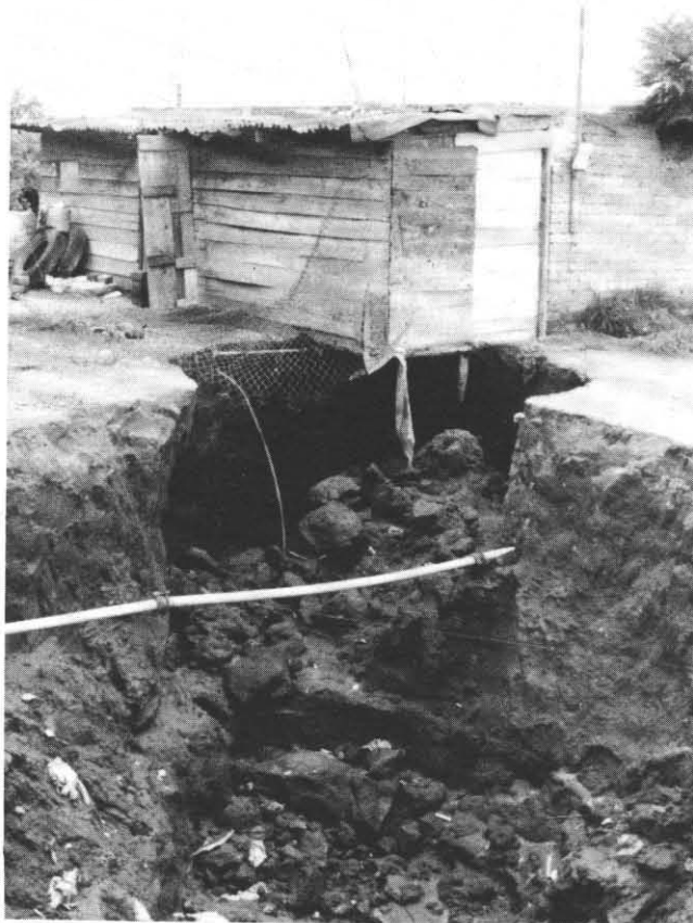
Fig. 3. La grieta principal de Chicoloapan y la casa dañada.
