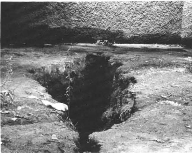
Fig. 9. La grieta de Ayotla afectó una casa en construcción.
