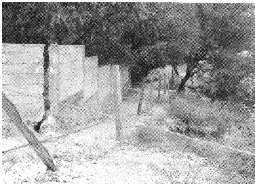
Fig. 12. Grieta en una barda de la esquina de las calles Juárez y Vasco de Quiroga (estación 2): a) el 15 de mayo de 1992, b) el 21 de octubre.
