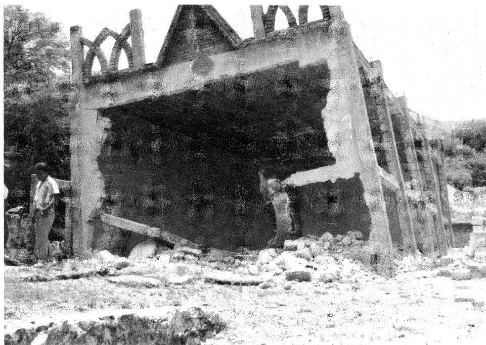
Fig. 10. Esta construcción (templo evangélico) se inclinó hacia el lado contrario del desplazamiento, lo que demuestra el movimiento rotacional de los bloques. La fotografía fue hecha el 15 de mayo; el movimiento continuó y dos meses después se colapsó totalmente.
