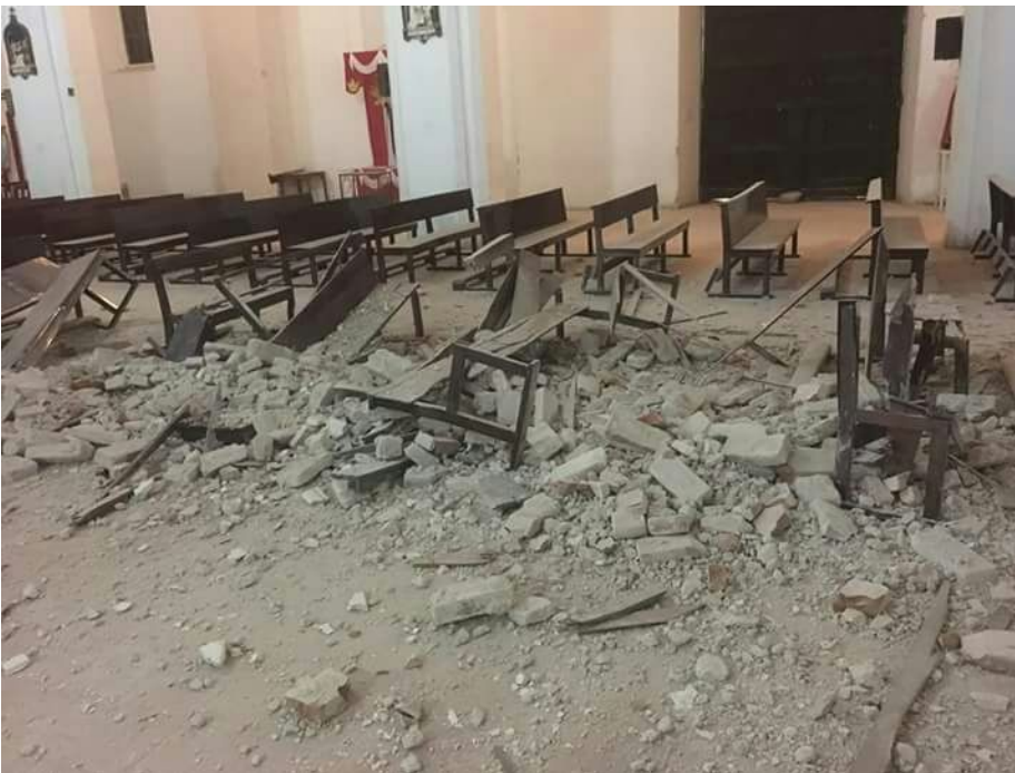
Figura 4. Daños considerables en el interior del Templo de Santo Domingo.
