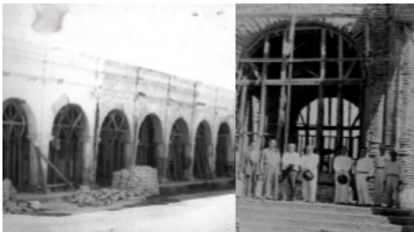
Figura 2. Daños en los portales y caída de uno de los remates de los arcos botareles de la fuente colonial de Chiapa de Corzo, Chiapas por el sismo de 1975.
