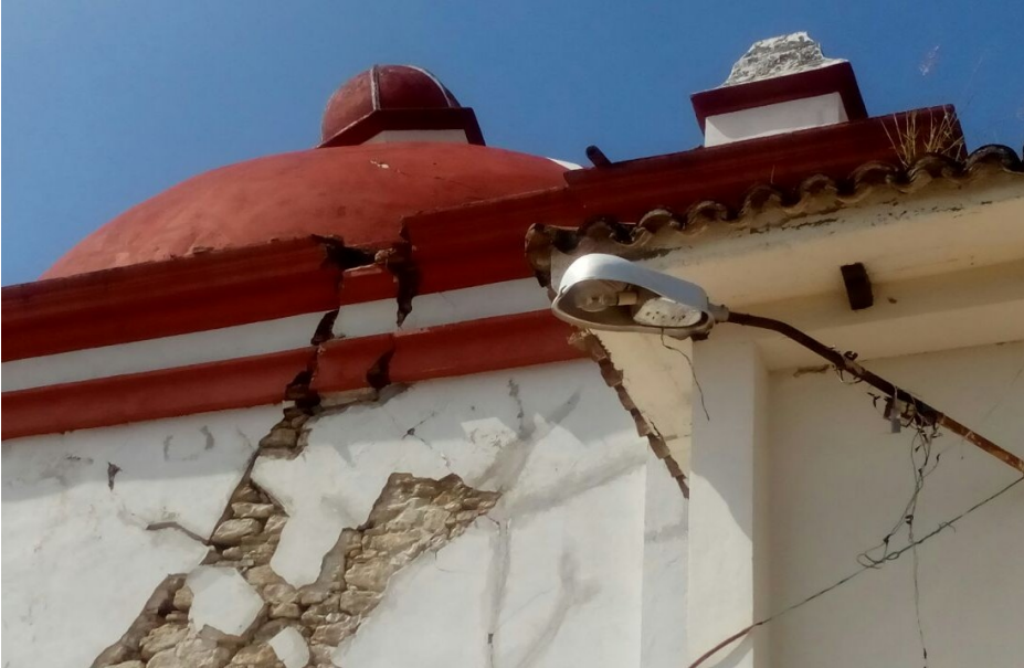
Figura 3. Daños en la cúpula de la Iglesia del Calvario.
